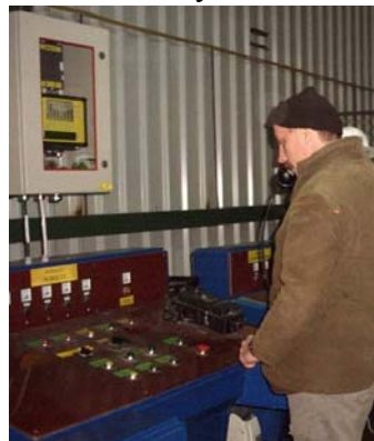
Foto 6. Sterownik powierzchniowy systemu. Stanowisko operatora wciągarek bębnowych
